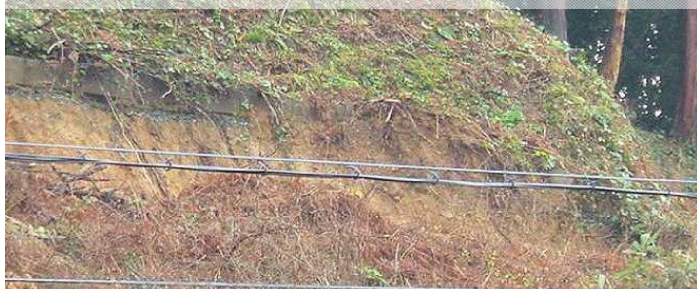
水路閉塞が原因となった法面崩壊例
